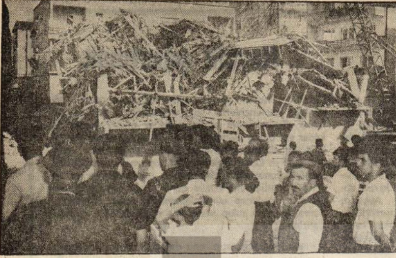
İNŞAAT, ÇÖKÜNTÜDEN SONRA: 6 işçinin mezarı
